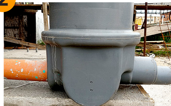
Vista lateral da caixa. Tubulação laranja é a que vai para rede coletora da CASAN. Tubulação em cinza é o local para realizar a conexão da residência.
