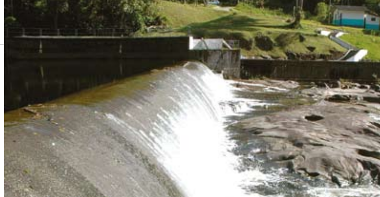
Captação de água no Rio Vargem do Braço (Pilões), em Santo Amaro da Imperatriz: sistema que abastece a região metropolitana da Capital
