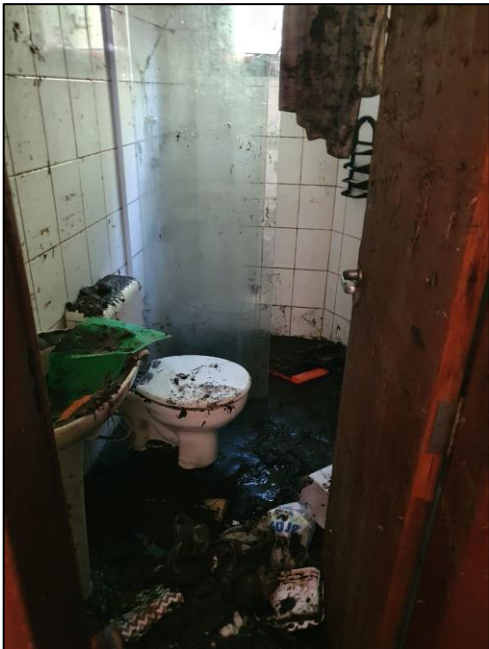
Figura 6 - Banheiro com lodo, antes de receber limpeza. Fonte: CASAN, 2021.
