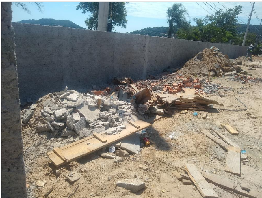
Figura 22 - Terreno Av. das Rendeiras com resíduos. Fonte: CASAN, 2021.
