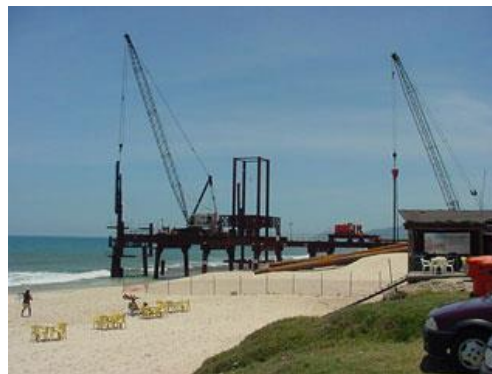
Pier do emissário da Barra da Tijuca – 5 km de extensão para uma vazão final de 5,3 m 3 /s
