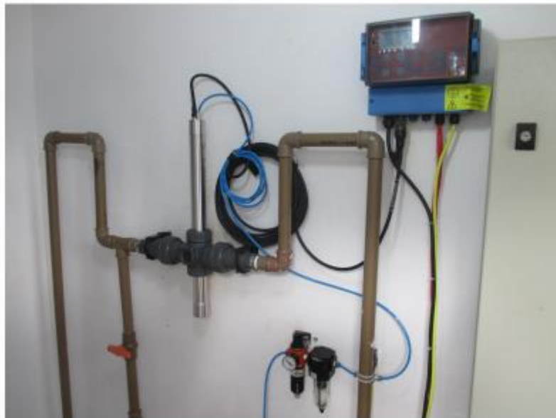
b) Instalação ao ar livre com caixa de proteção
