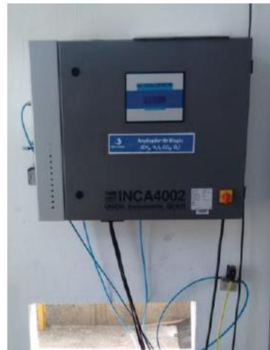
Quadro de medição da Union
